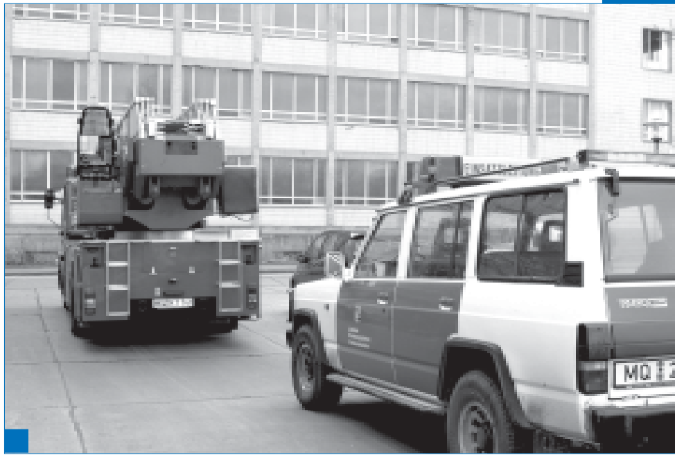
19. Januar 2007 gegen 12.00 Uhr: Auf der Baustelle hatte ein Kabel Feuer gefangen, die Städtische Feuerwehr war nach wenigen Minuten zur Stelle. Der entstandene Schaden blieb gering. Foto: privat
